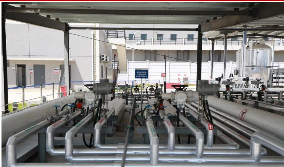
图 23 小虎岛电氢智慧能源站
